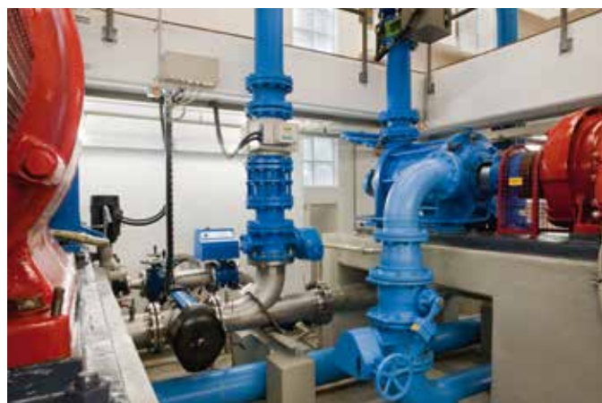
Rohrkeller in einem Pumpwerk
