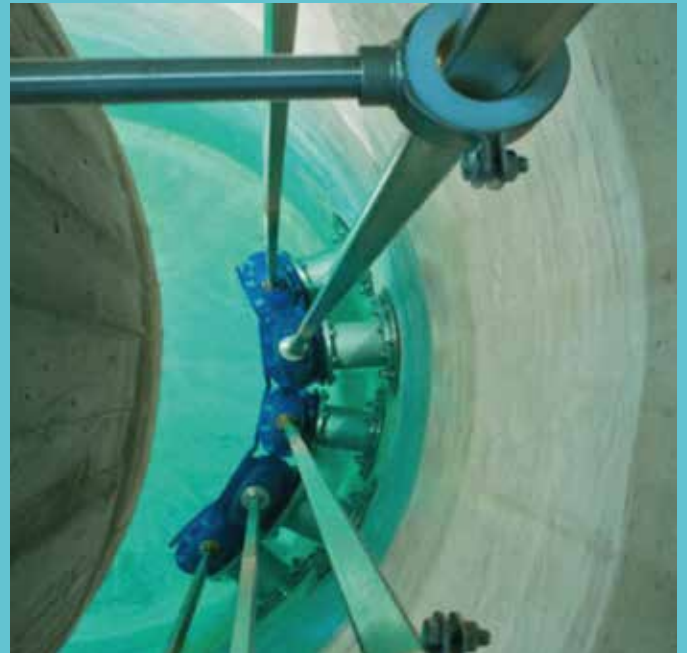
Grundwasserfassung Böschenbach bei Mogelsberg
